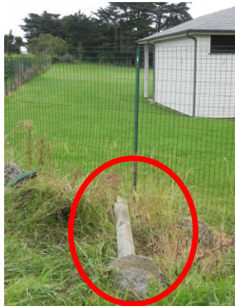
Panneau et socle béton arrachés
